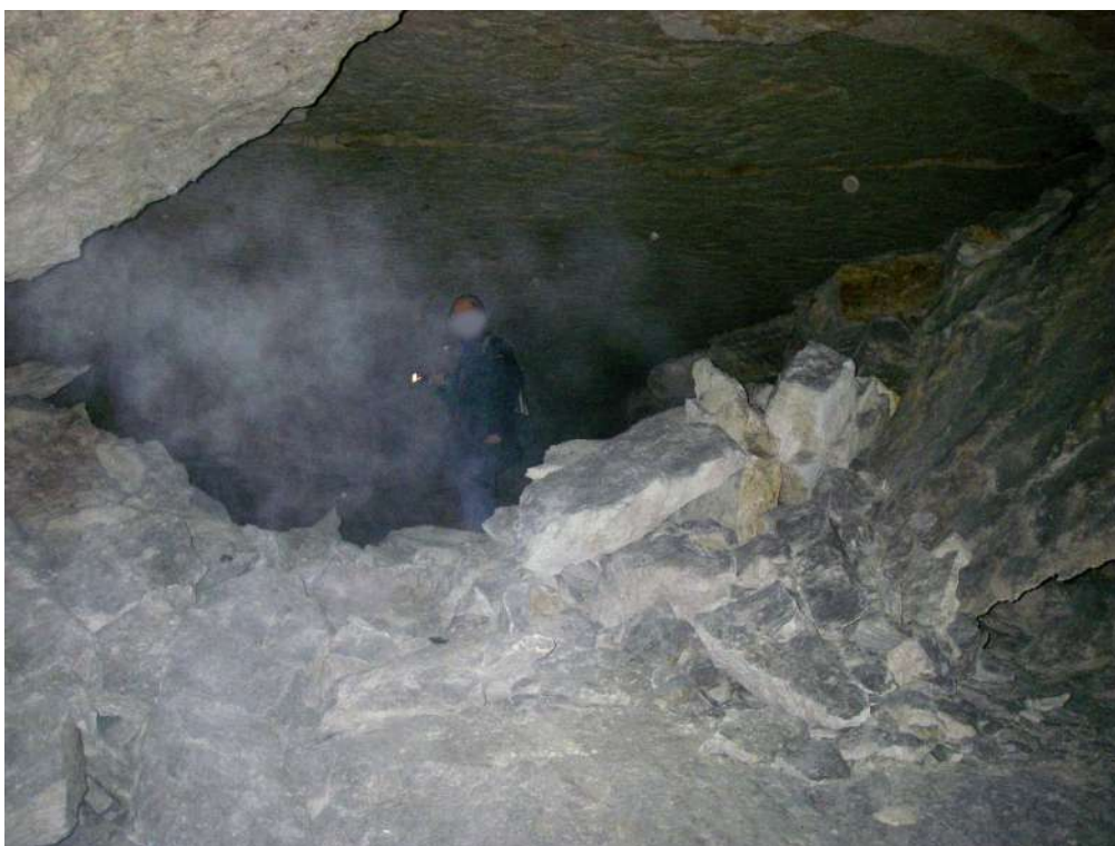
Photo 1 : Exemple d'un ciel tombé situé dans une des carrières de Conflans.
